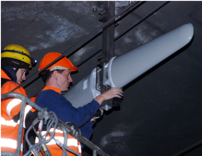
Herr Christian Grossen und Herr Jürg Zbinden der Alpine-Energie montieren eine Richtantenne für die Mobilfunk Versorgung im Tunnel Oerlikon auf der neuen Durchmesserlinie der SBB.
