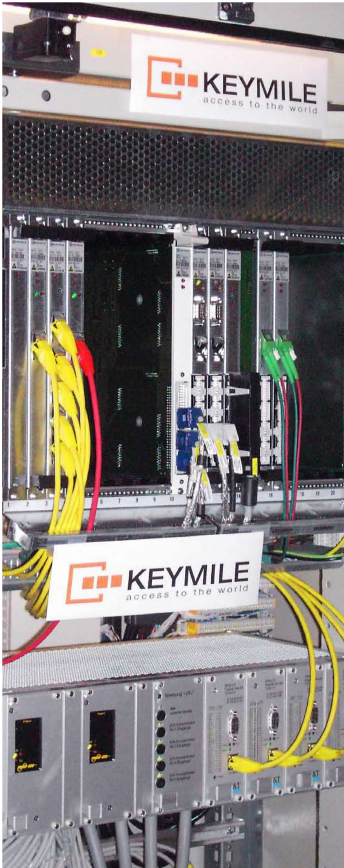
KEYMILE UMUX im Lötschberg-Basistunnel
